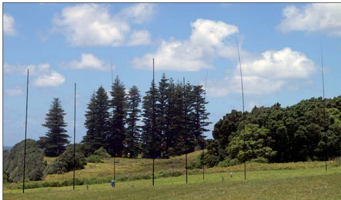
Zwei Four Square-Antennen für 80 m und 40 m
