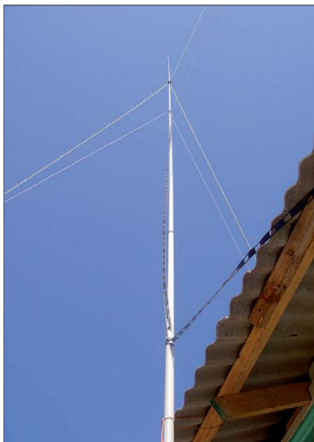
Bild 1: Ansicht der fertig aufgebauten Triple-Leg mit der zuführenden Wireman-Leitung
